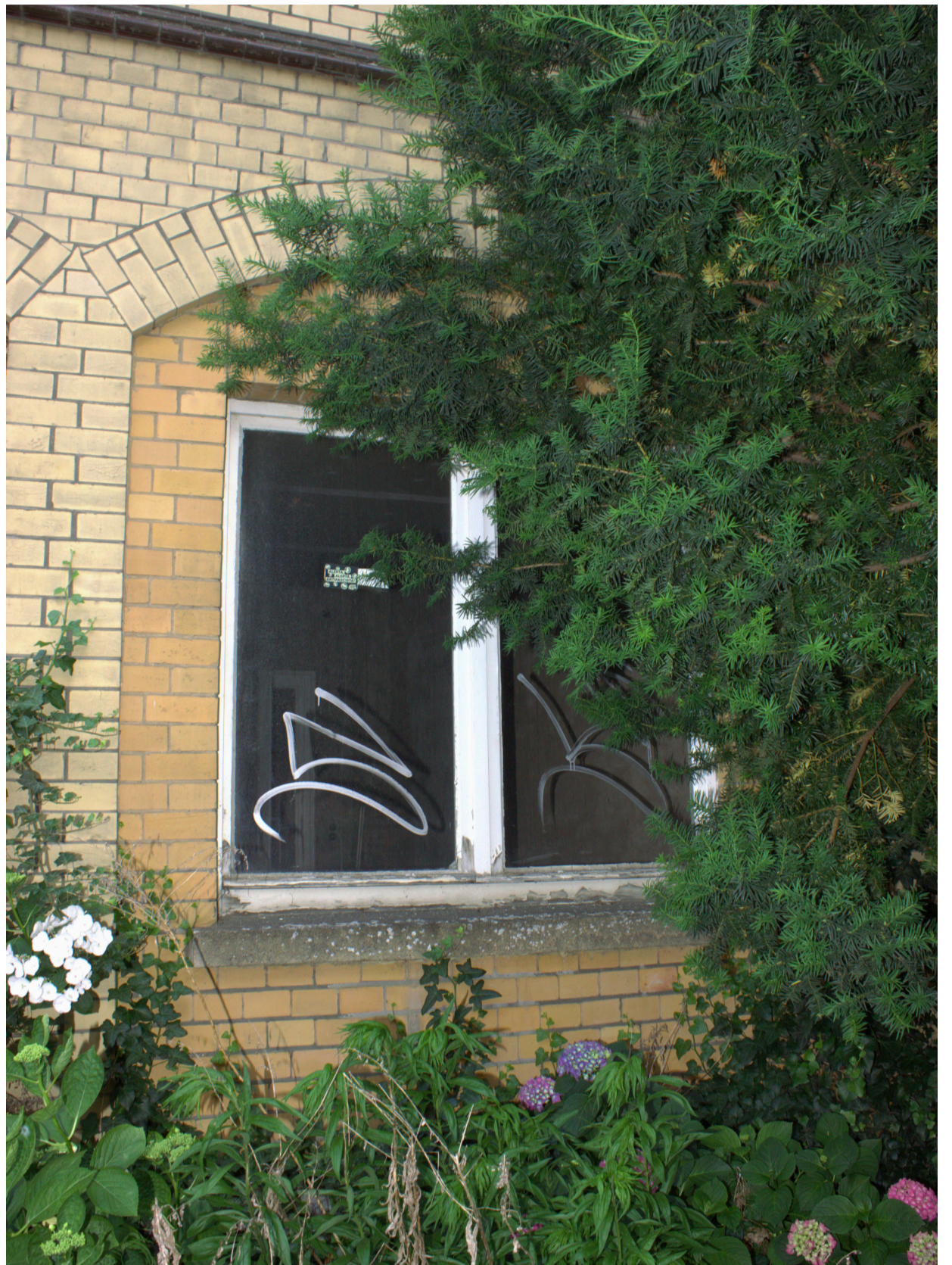
Blick in ein leerstehendes Haus im Vorderen Westen.
